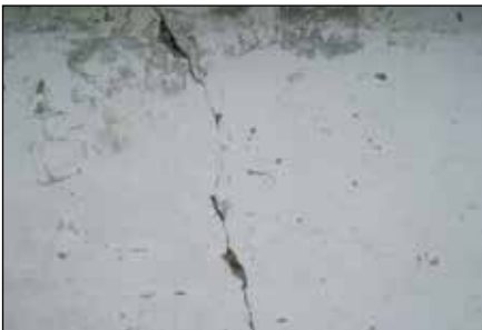
Eventuelle sætningsrevner udbedres (se side 19).
